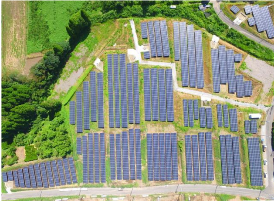
〈川辺大田尾発電所〉
