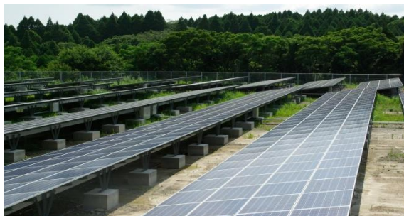
＜額娃町太陽光発電所＞
