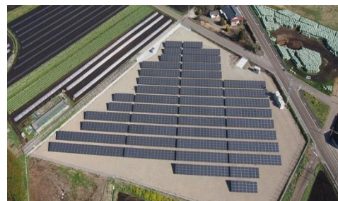
<大福川南太陽光発電所>
