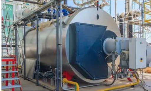
小規模温泉施設などのボイラー施設
