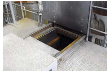
〈アスベスト溶融投入口〉
