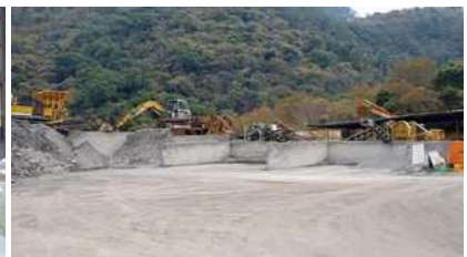
〈コンクリート破砕施設〉
