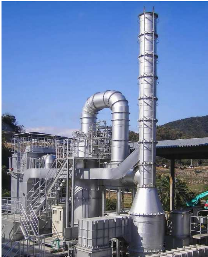
《アスベスト溶融炉の附属施設》
