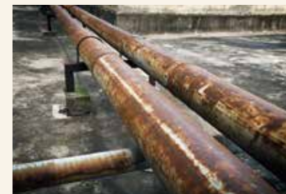
パイプラインの老朽化
